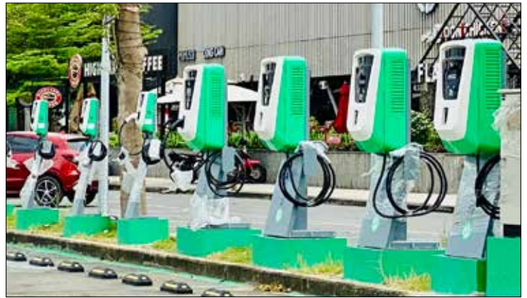
▲ Trạm sạc điện do VinFast lắp đặt tại Trung tâm thương mại TX. Phú Mỹ, tỉnh Bà Rịa - Vũng Tàu
