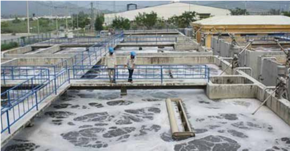
▲ Hệ thống xử lý nước thải tại KCN Bảo Minh, tỉnh Nam Định
