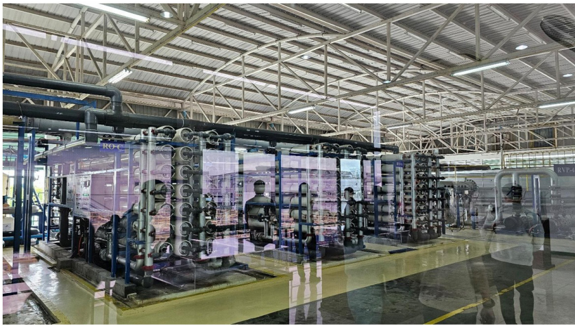
Hệ thống tái chế nước thải sau xử lý bằng công nghệ thẩm thấu ngược (RO) tại KCN Amata City Chonburi
