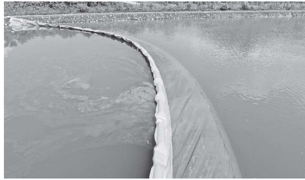
Giải pháp tách lọc thu hồi dầu “khó nhìn thấy” lắp trong nước tại cửa lấy nước thô của Nhà máy nước sạch Sông Đà (tỉnh Hòa Bình) nay là tỉnh Phú Thọ
