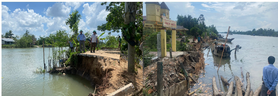
Hình 1. Tình trạng sạt lở tại một số bờ sông thuộc khu vực ĐBSCL năm 2024
