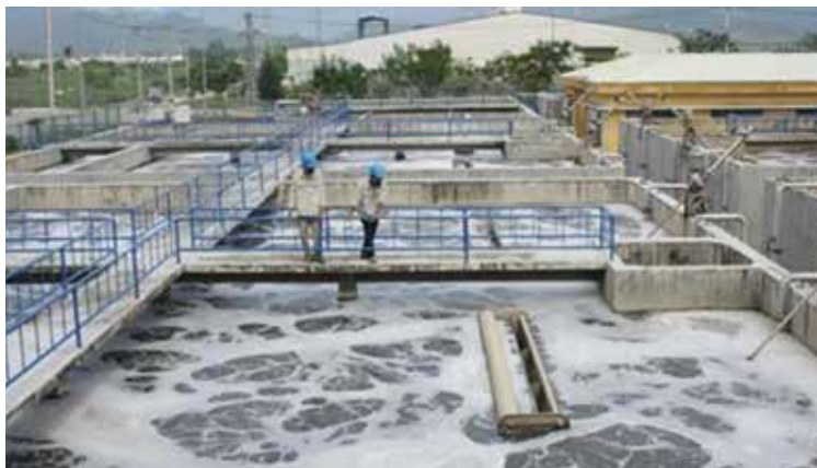
▲ Hệ thống xử lý nước thải tại KCN Bảo Minh, tỉnh Nam Định
