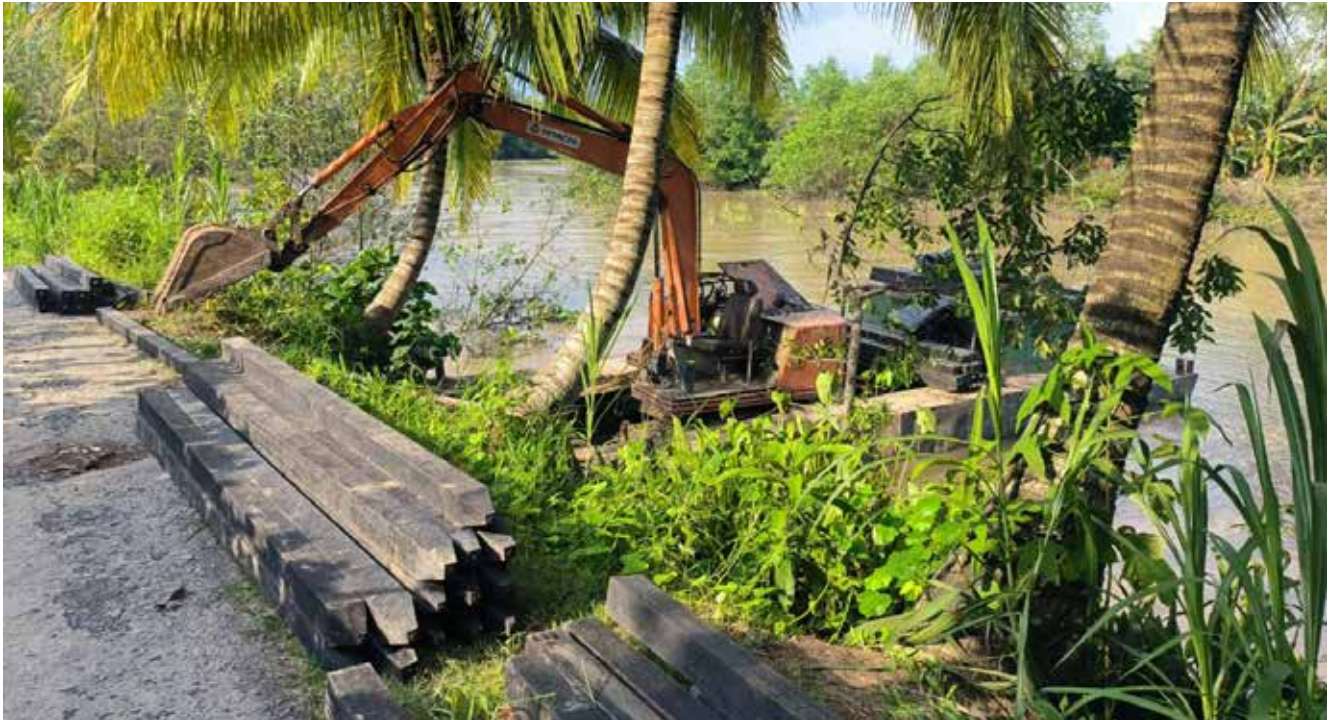
▲ Hình 7b. Thi công cọc composite PE/trấu tại sông Cái Cầu, ấp Phú Thạnh, xã Phú Đức, huyện Long Hồ, tỉnh Vĩnh Long
