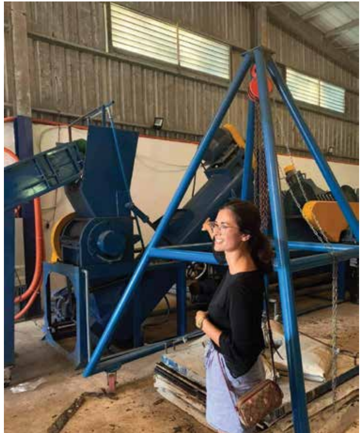
▲ Dây chuyền công nghệ xử lý rác thải nhựa của Dự án ReForm Plastic tại Nhà máy ở Hội An
