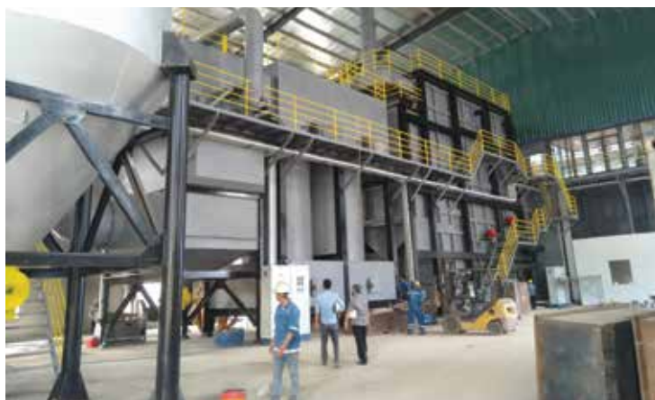
▲ Dây chuyền lò đốt CTR sinh hoạt của Công ty Cổ phần Môi trường Nghi Sơn
