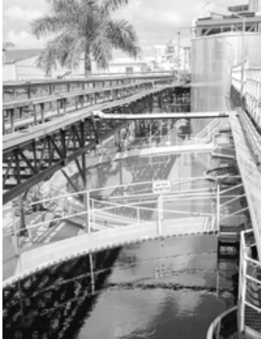
▲ Hệ thống xử lý nước thải tập trung tại Nhà máy Ajinomoto Biên Hòa (Đồng Nai) của Công ty Ajinomoto Việt Nam
