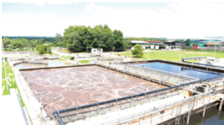
▲ Hệ thống xử lý nước thải KCN Long Thành 1, tỉnh Đồng Nai
