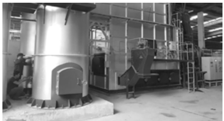
▲ Hệ thống lò đốt
