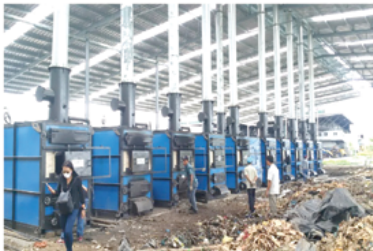
▲ Hệ thống lò đốt rác của Nhà máy xử lý CTR Vietstar Lemna Eco Center (huyện Củ Chi)
