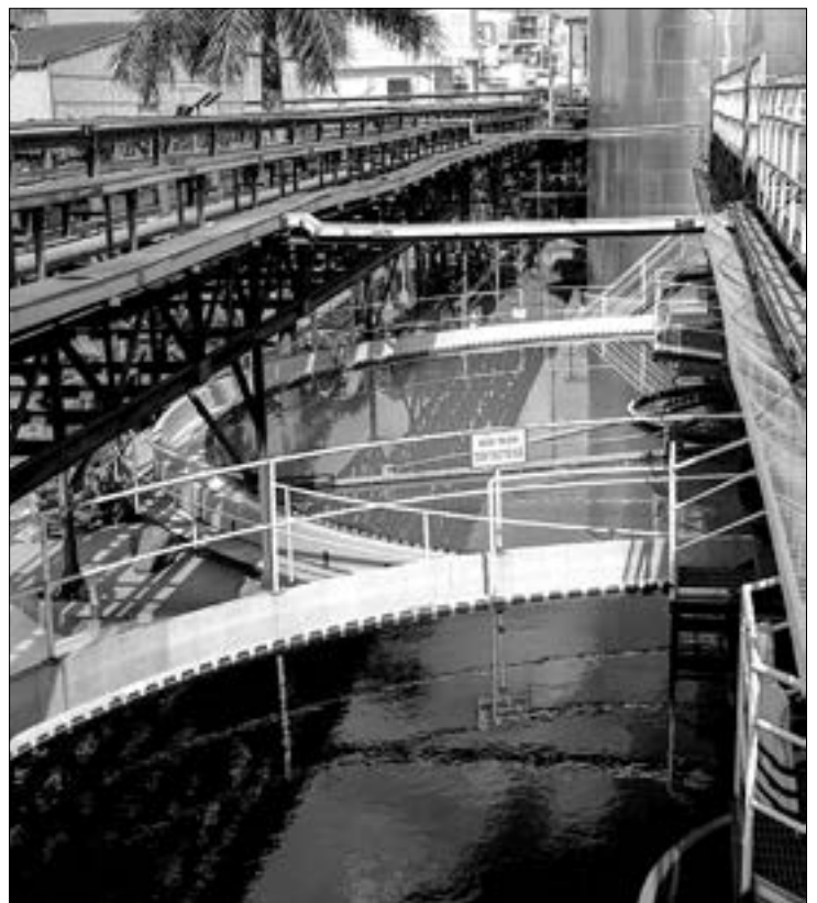
▲ Hệ thống xử lý nước thải tập trung tại Nhà máy Ajinomoto Biên Hòa (Đồng Nai)
