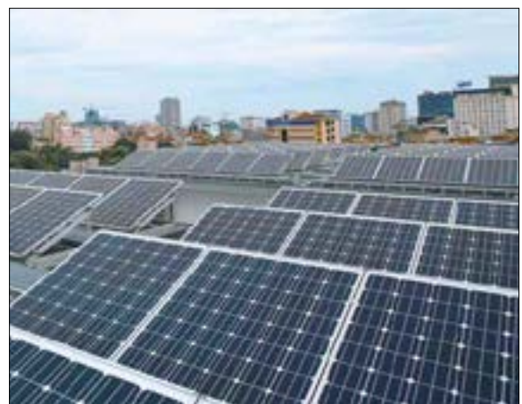
▲ GOUNH sử dụng 408 tấm pin năng lượng mặt trời
