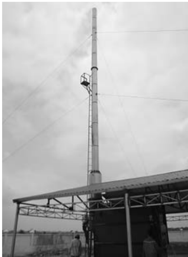
▲ Lò đốt rác thải sinh hoạt do Công ty STEPPO lắp đặt tại xã Nghĩa An, huyện Nam Trực, tỉnh Nam Định
