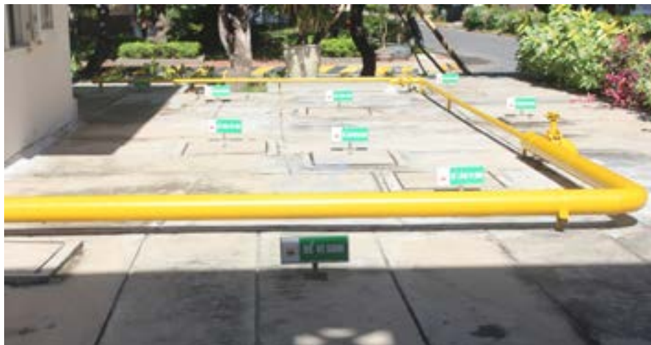
▲ Hệ thống XLNT của Nhà máy thuốc tiêm
