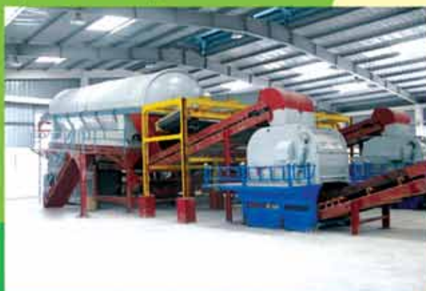
Dây chuyền xử lý rác thải sinh hoạt
