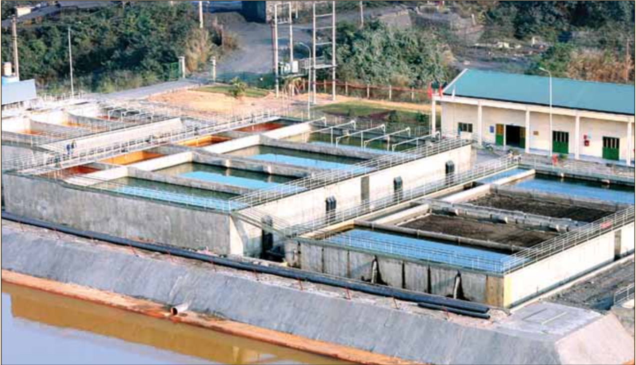
▲ Trạm xử lý nước thải mỏ than Cốc Sáu tại TP Cẩm Phả (Quảng Ninh) do Công ty Cổ phần Tin học, Công nghệ và Môi trường Than - Khoáng sản Việt Nam đầu tư xây dựng với tổng vốn gần 90 tỷ đồng, công suất 2.400 m 3 /h, sử dụng công nghệ hóa lý, vận hành khép kín bằng hệ thống các bể lắng, lọc xử lý nước thải từ moong mỏ Cốc Sáu. Ảnh: TTXVN
