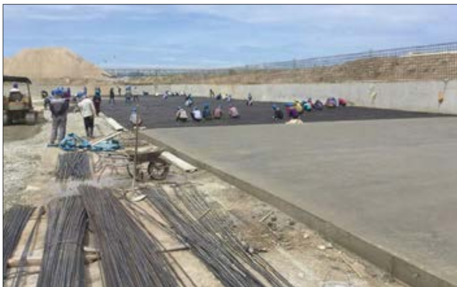
▲ Bãi thải xỉ của FHS được xây bờ dê kiên cố bằng đá khối cao 7 m, phía trong dê được phủ 2 lớp vải lọc theo đúng Báo cáo ĐTM
