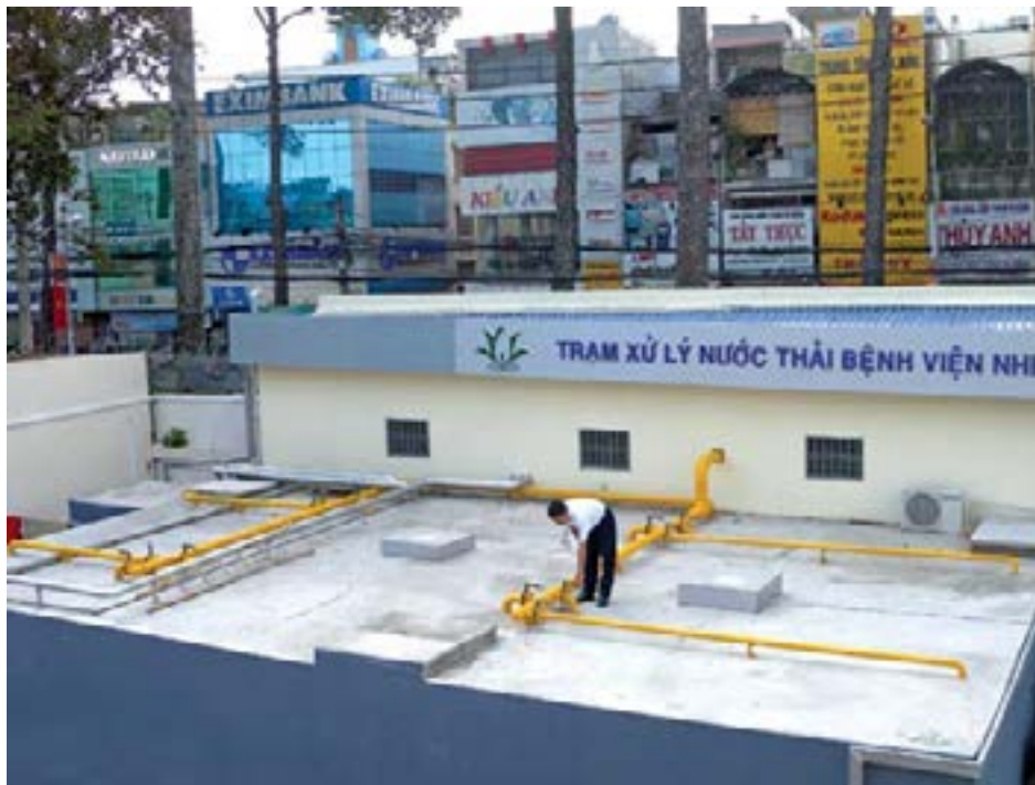
▲ Trạm xử lý nước thải Bệnh viện Nhi
