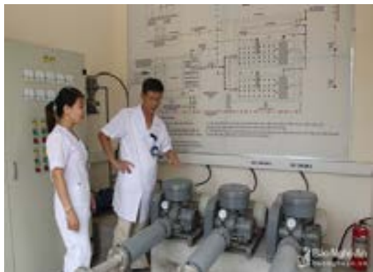
▲ Hệ thống vận hành xử lý nước thải tại Bệnh viện Lao và bệnh Phổi Nghệ An
