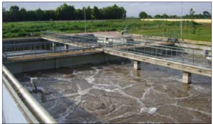
▲ Hệ thống xử lý nước thải của Nhà máy Bia Sài Gòn - Đắk Lắk
