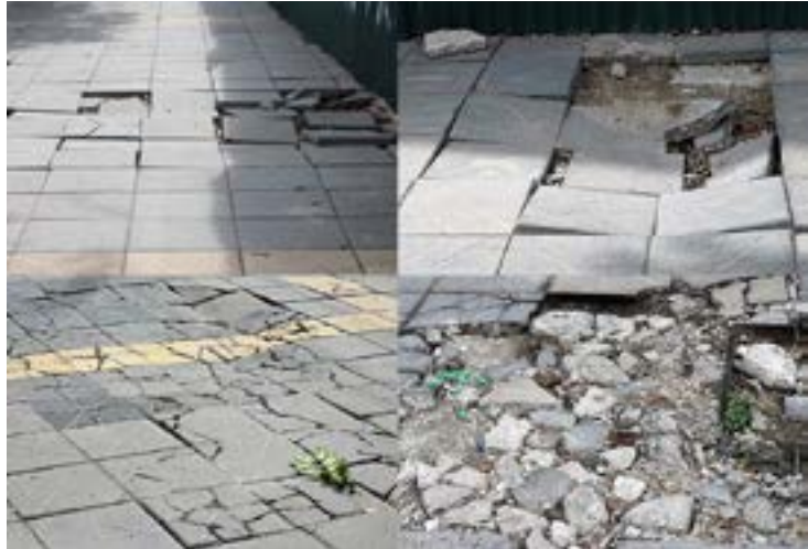
▲ Vỉa hè đường Nguyễn Chí Thanh và Láng Hạ đang bị xuống cấp nghiêm trọng
