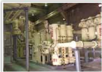
Trạm phân phối 220kV kiểu kín (GIS)
