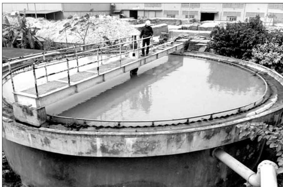
▲ Hệ thống xử lý nước thải tại KCN Lễ Môn
