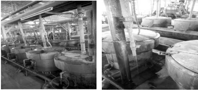
▲ Hình 4. Các vị trí rò rỉ nước tại các hệ thống li tâm tách bã và li tâm lọc
