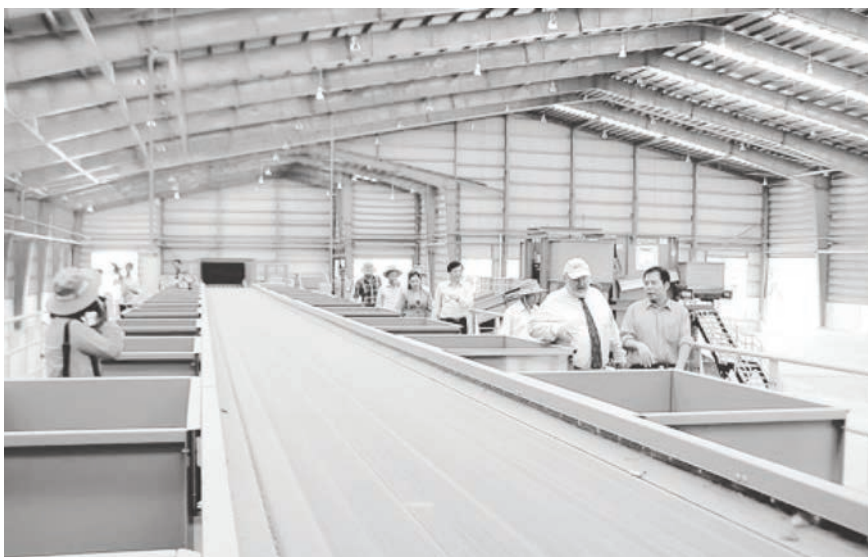
▲ Dây chuyền phân loại rác của Nhà máy xử lý rác Đa Phước
